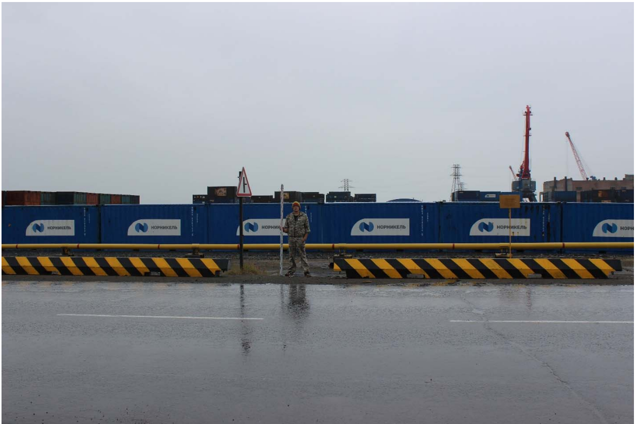
Рис. 15. «Строительство газопровода от котельной № 7 до котельной «Дукла» и газопоршневой электростанции мощностью 3МВт», Красноярский край, Таймырский Долгано-Ненецкий муниципальный район, г. Дудинка, 2024 г. Общий вид. Фото с северо-востока. Точка съемки № 5.
