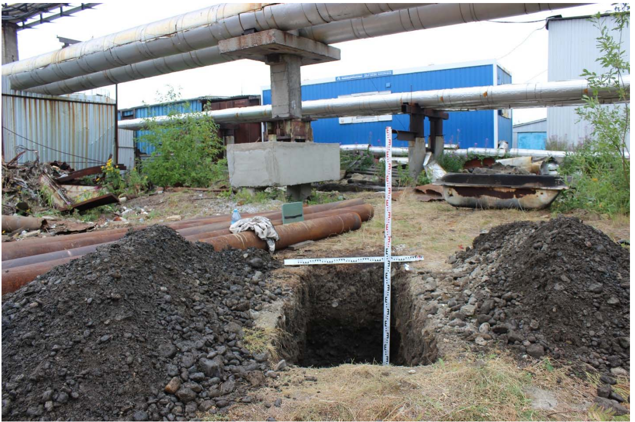
Рис. 23. «Строительство газопровода от котельной № 7 до котельной «Дукла» и газопоршневой электростанции мощностью 3МВт», Красноярский край, Таймырский Долгано-Ненецкий муниципальный район, г. Дудинка, 2024 г. Шурф № 1. Общий вид шурфа. Фото с юга.
