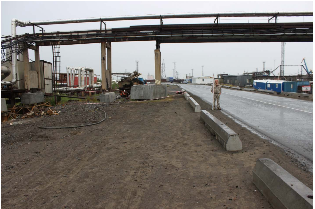
Рис. 11. «Строительство газопровода от котельной № 7 до котельной «Дукла» и газопоршневой электростанции мощностью 3МВт», Красноярский край, Таймырский Долгано-Ненецкий муниципальный район, г. Дудинка, 2024 г. Общий вид. Фото с северо-запада. Точка съемки № 1.
